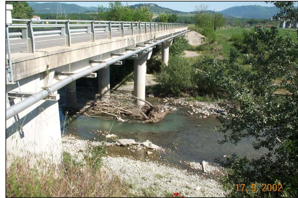
Idrometro a PONTE DI MONTERUFOLI
